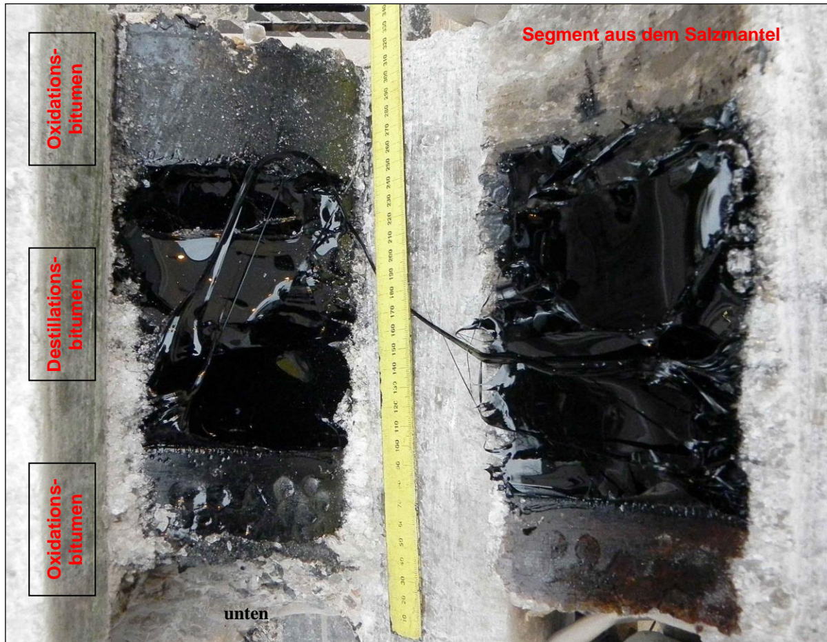
Abbildung 73: Bitumendichtung bei BIT-01 direkt nach Abschlagen des Segmentes aus dem Salzmantel
